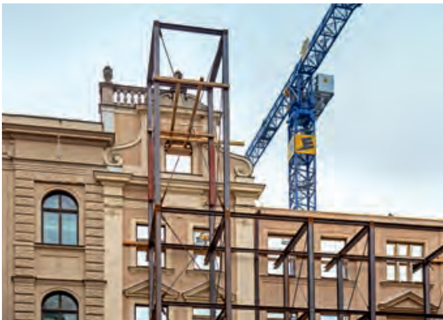
Ein Stahlgerüst umklammert die Fassade der ehemaligen Staatsbank. Steel scaffolding embraces the facade of the former state bank.
