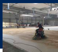
In der Abfüllhalle wird im Akkord gefliest Tiles are laid non-stop in the filling hall
